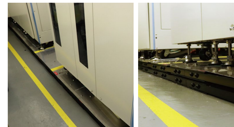
東邦大学医療センター大森病院様 (透析機械室)
