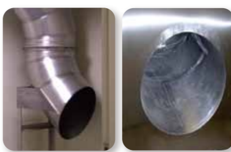
上部階で投入されたリネン/ダストが排出される出口です
