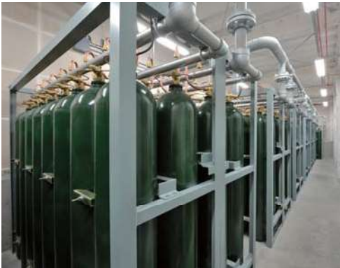
消火設備(CO2ポンペ)完備
