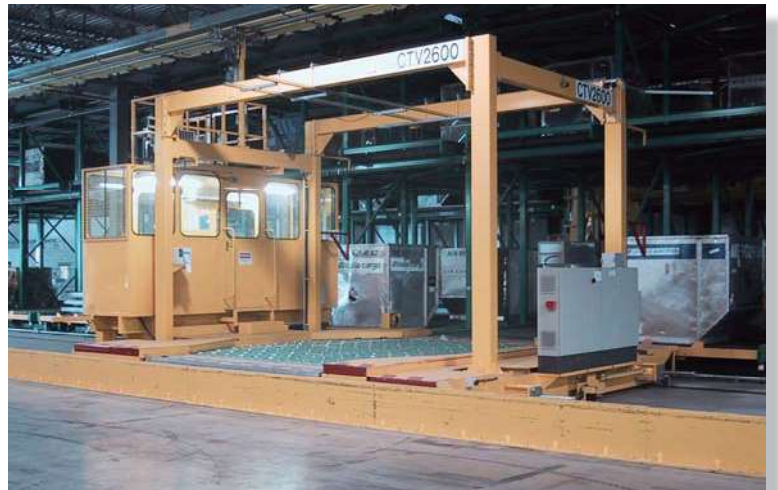
エア・カーゴコンテナを搬送するTV設備
