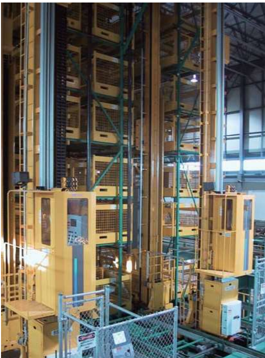
バルク(Bulk)を保管するASRS設備
