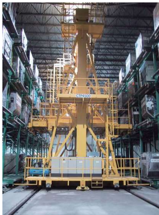
エア・カーゴコンテナを搬送及び保管するETV設備
